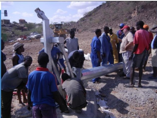
Personal local atendiendo a las explicaciones de cómo instalar y operar el sistema de elevación de la torre
